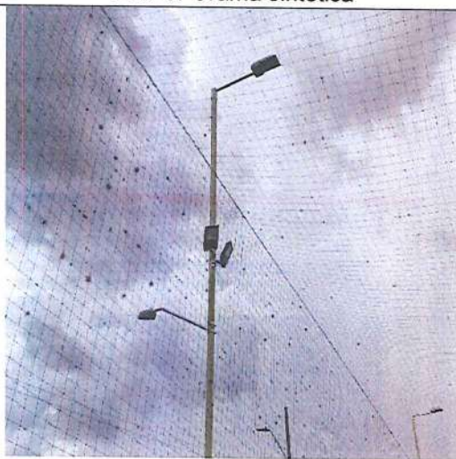
Foto 8. Sistema de iluminación
