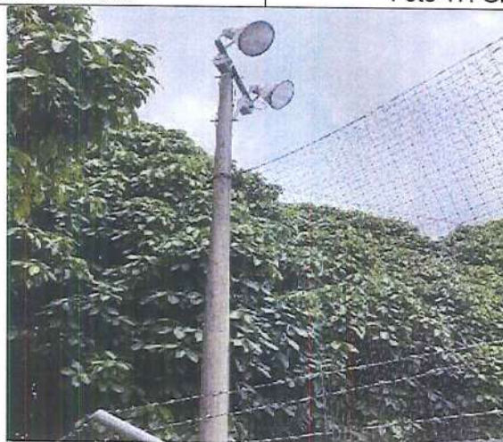
Foto 18. Sistema de Iluminación
